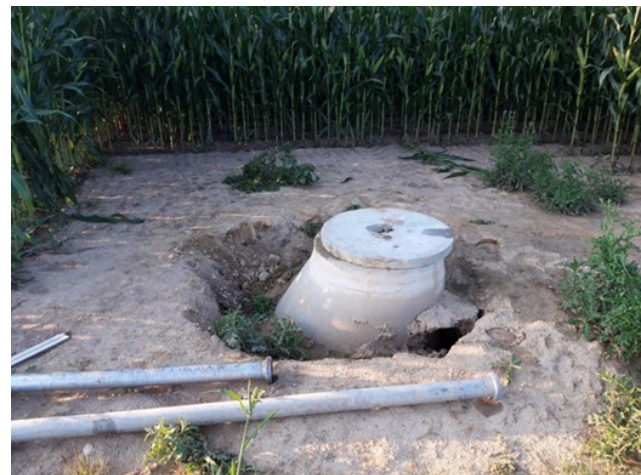
Bild 1: Gelände um den Brunnenkopf sackt in den ersten Jahren ab (Foto: A. Dorfmeister)
