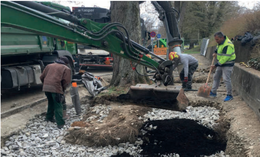
Bild 4: Sanierung von Baumstandorten nach dem Stockholmer-Modell in der Stadt Rottweil (C. Biber, Stadt Rottweil)
