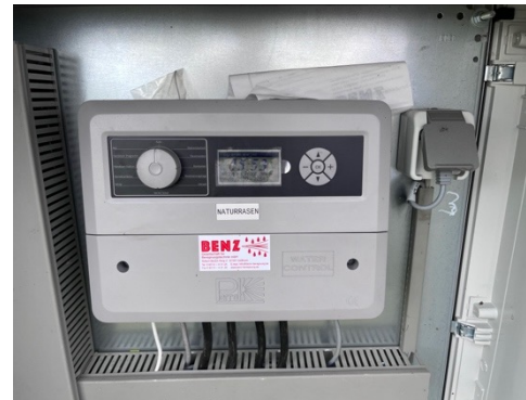
Steuereinheit in Schaltkasten
